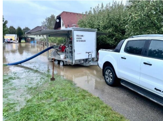
Bild 2: Koordiniert kommen die Pumplösungen dort zum Einsatz, wo sie am dringendsten benötigt werden.
